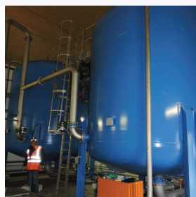
Les équipements de la nouvelle station
